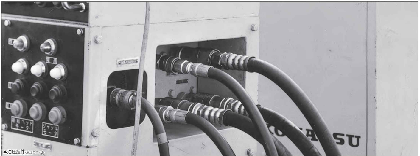
▲油压组件/油圧ユニット
