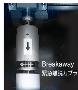
Ikegami Hydrogen Station 池上水素ステーション
